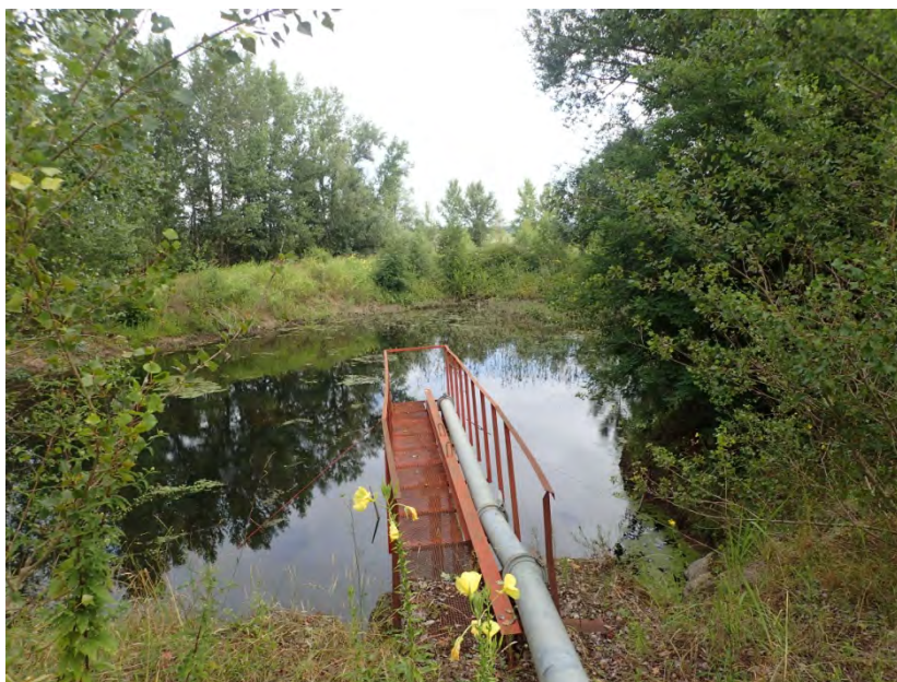
Bassin d'eau claire et de pompage des installations de traitement (source : SOE)
